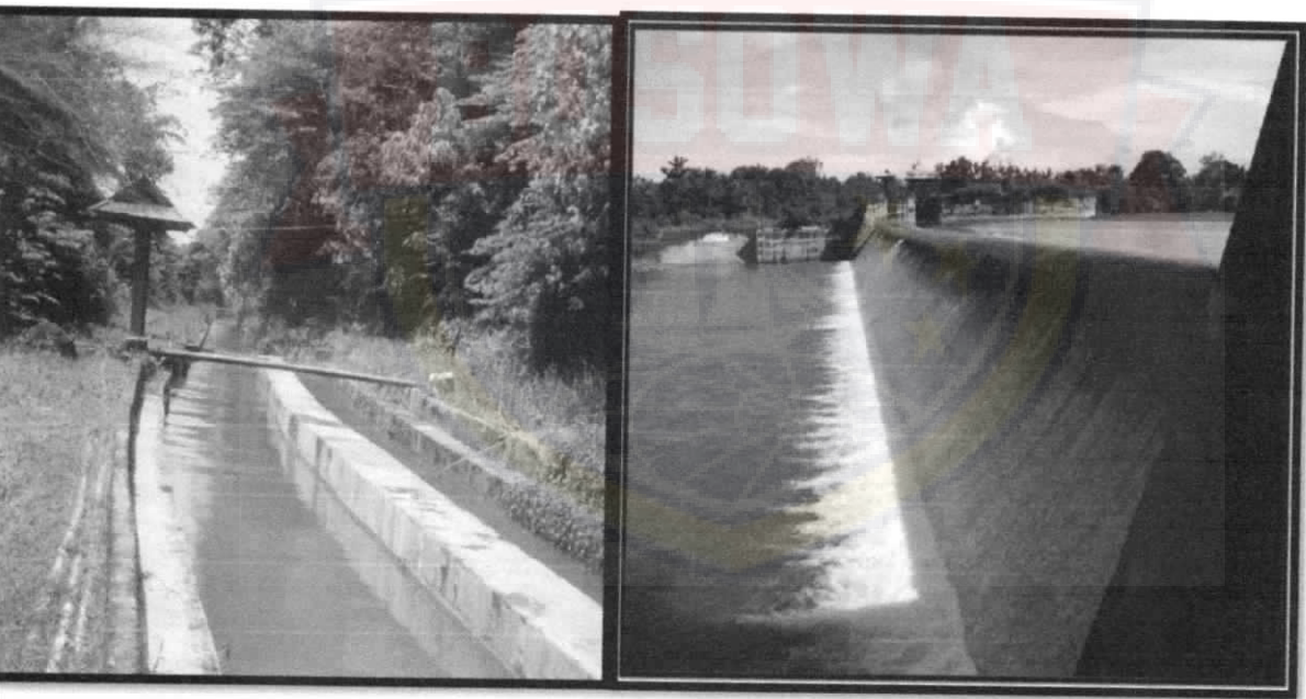
Gambar 4.3: Kondisi Jaringan Irigasi Singkoyo dn Sinorang di Kawasan Koridor Pantai Selatan (Batu-Toili) Tahun 2013
