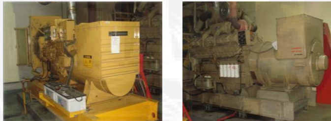
Gambar 5.5 : Mesin GenSet pada Bangunan (Sumber : Alkadry Darmawan, 2014)
