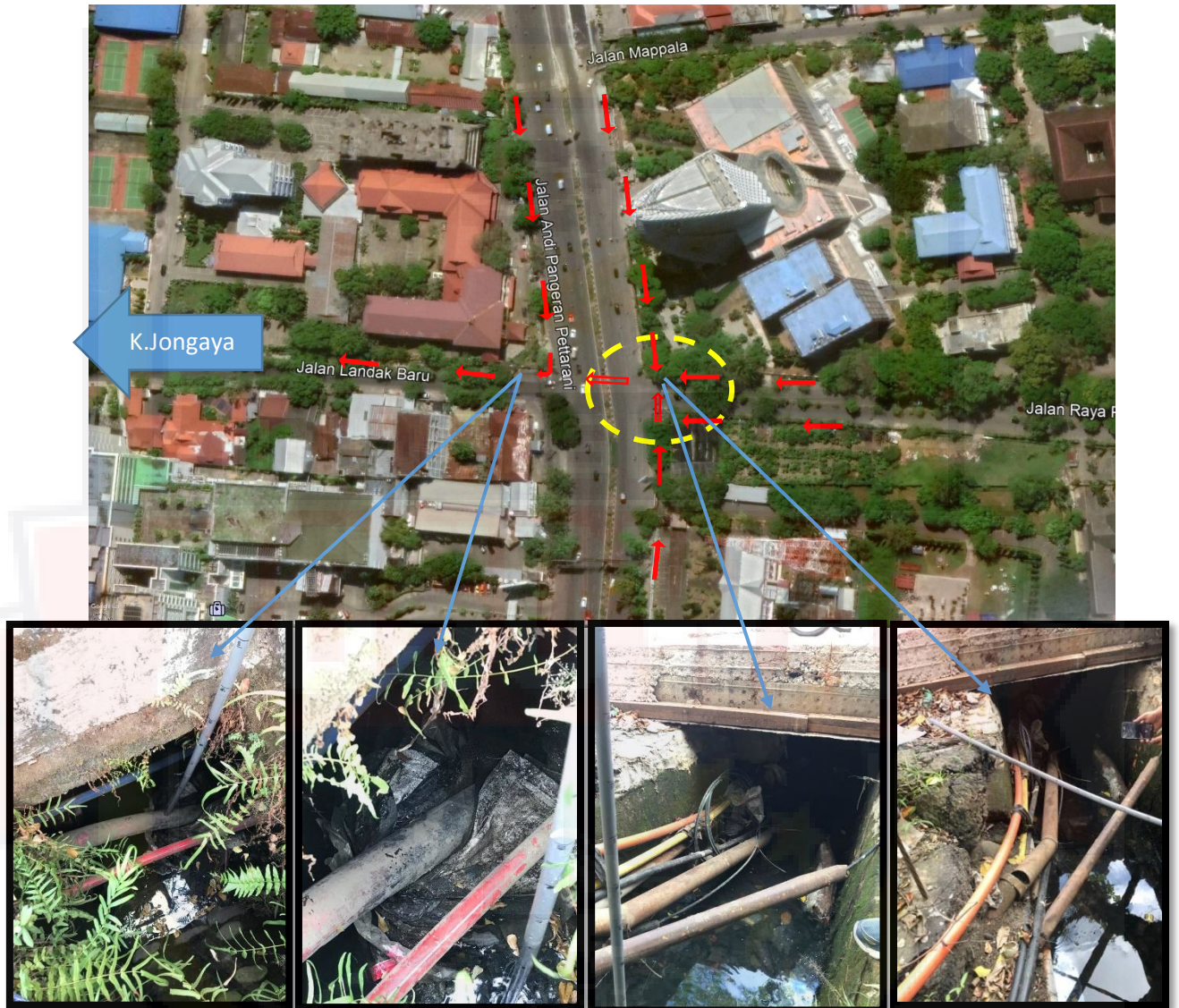
Gambar 4.20 Detail Lokasi terjadinya penyumbatan akibat kabel telkom, sedimen, dan sampah
