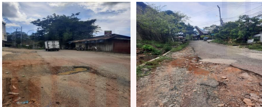
Gambar 4.9 Kondisi Jalan (Sumber : Hasil Survei Lapangan, 2021)
