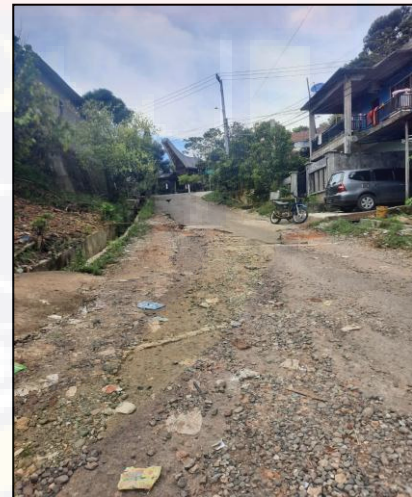
Gambar 4 : Dokumentasi Kondisi Jalan
