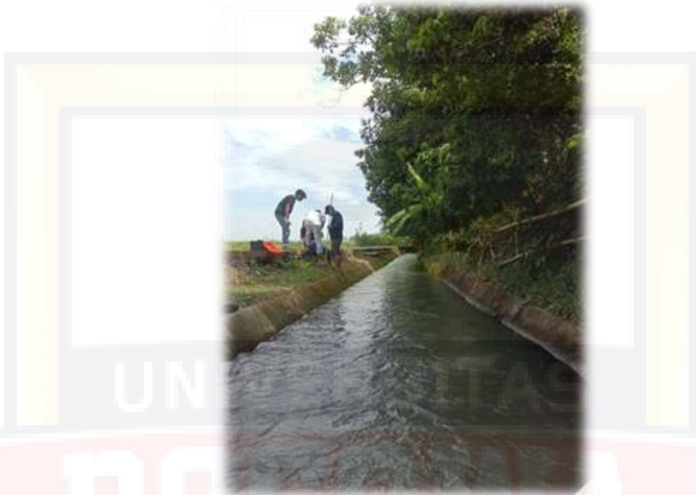
Gambar 4.2 Kondisi Bangunan Saluran Sekunder
