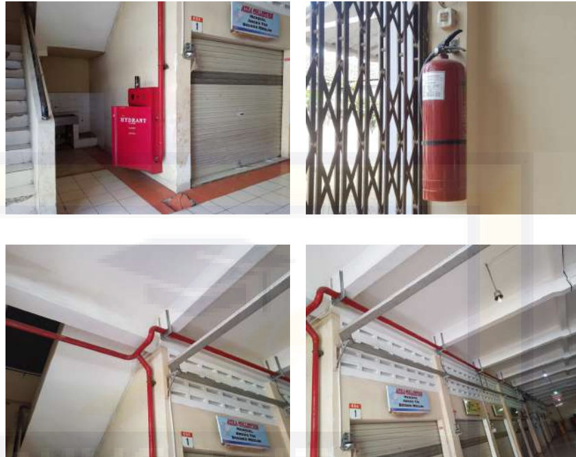
Gambar II. 23. Fasilitas Pemadam Kebakaran Pasar Segar Makassar Sumber : Dokumentasi Pribadi, 10 Juni 2021
