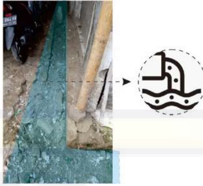
Gambar III.17. Drainase pada Pasar Terong Sumber : Dokumentasi Pribadi, 10 Juni 2021
