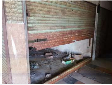
Gambar III.12. Los tidak layak pakai pada Pasar Terong Sumber : Dokumentasi Pribadi, 10 Juni 2021
