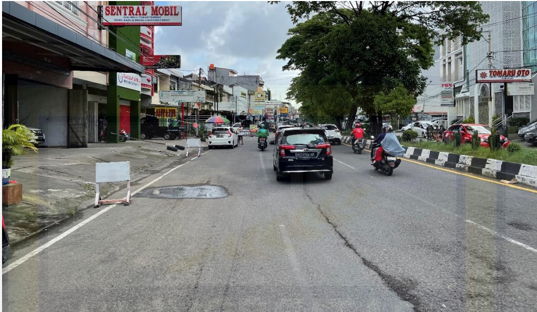
Gambar 4.65 Lokasi pada STA 1+300 – STA 1+400 yang memerlukan marka.
