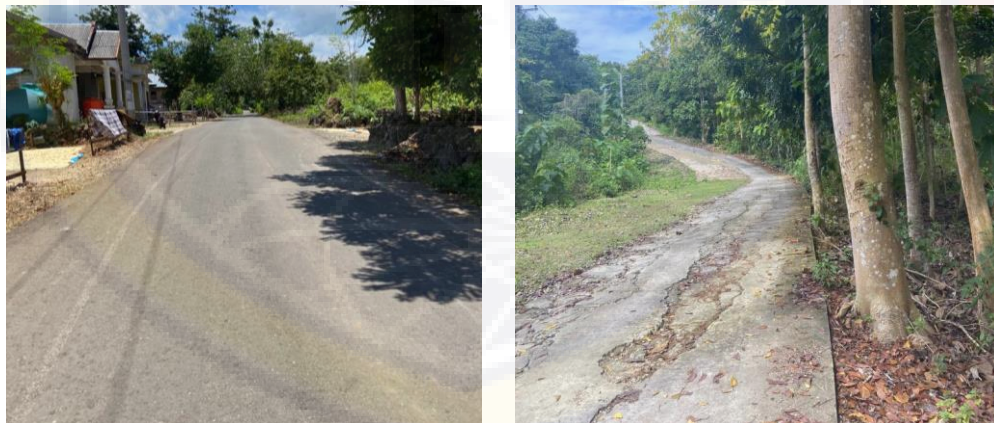
Gambar 4.3 Kondisi Jalan Sumber: Survei Lapangan Tahun 2022
