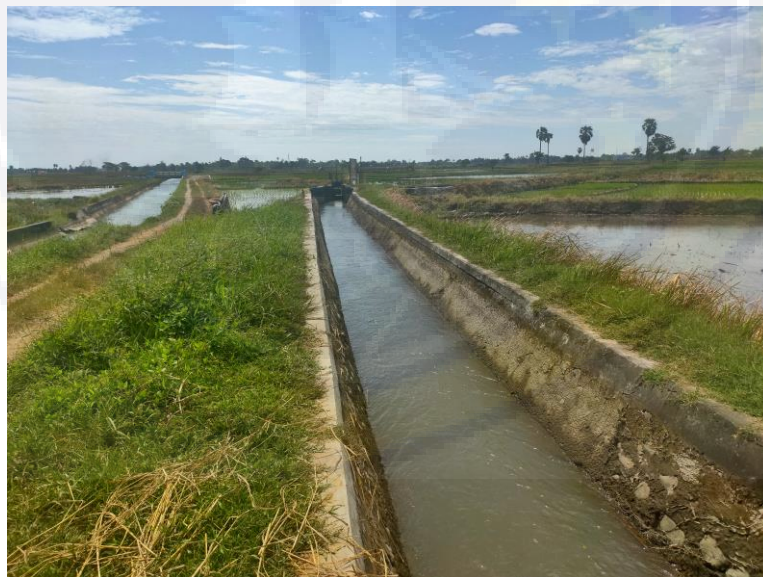
Gambar 4.4 Kondisi Saluran Sekunder Tampobalang Kiri
