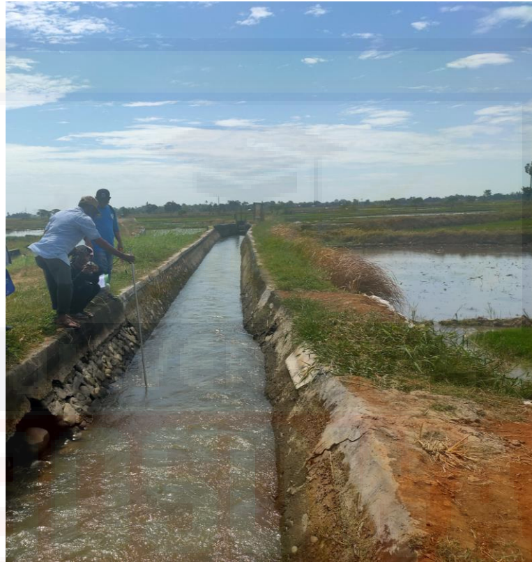
Gambar 4.3 Kondisi Saluran Sekunder Tampobalang Kanan
