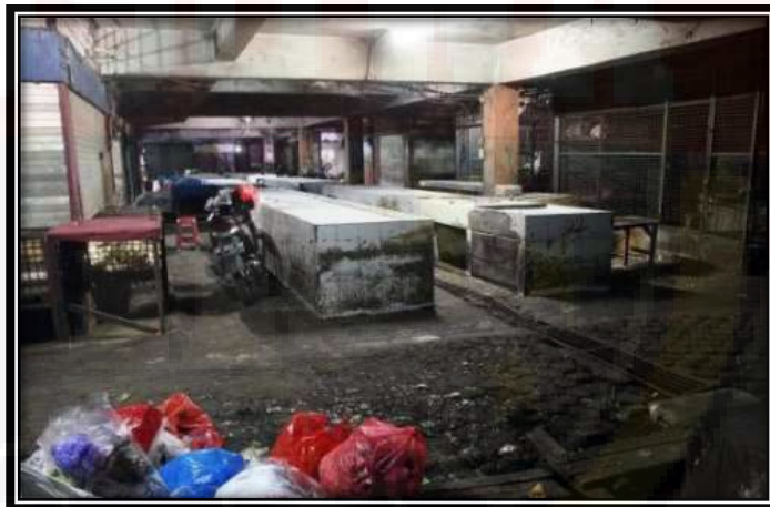
Gambar 3.9. Kondisi lantai basement yang becek dan tidak terurus dengan drainase yang sangat sempit
