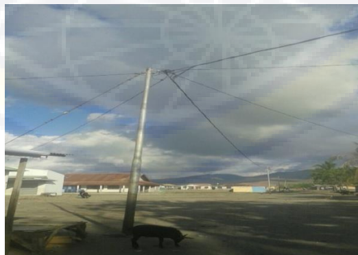
Gambar 4.9 Kondisi Jaringan Listrik di Desa Nangadhero
