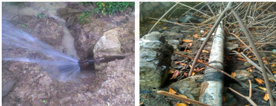
Gambar 4.12 Kondisi Kebocoran pipa dan Kondisi Pipa
