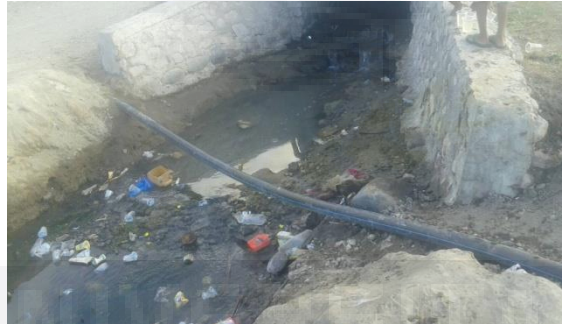
Gambar 4.8 kondisi jaringan drainase Desa Nangadhero
