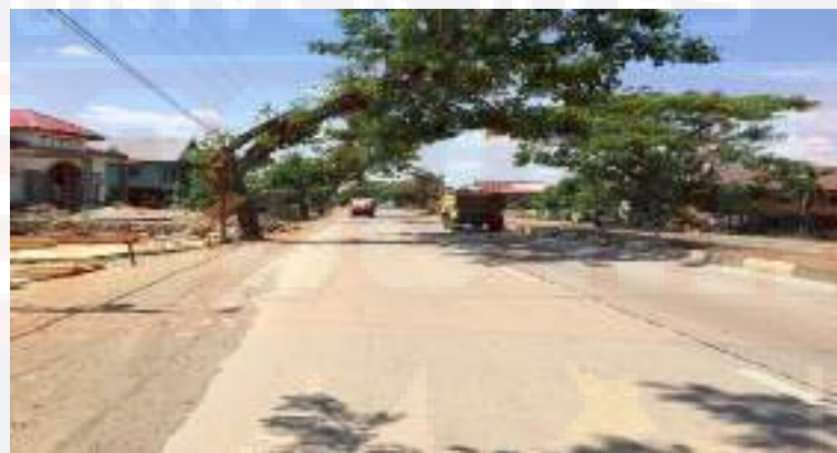
Dokumentasi Permukaan Rigid pada jalan terdapat celah
