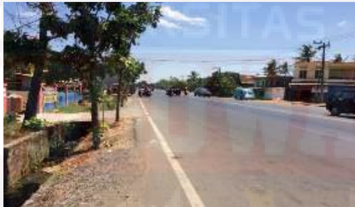
Dokumentasi Bahu jalan tergerus
