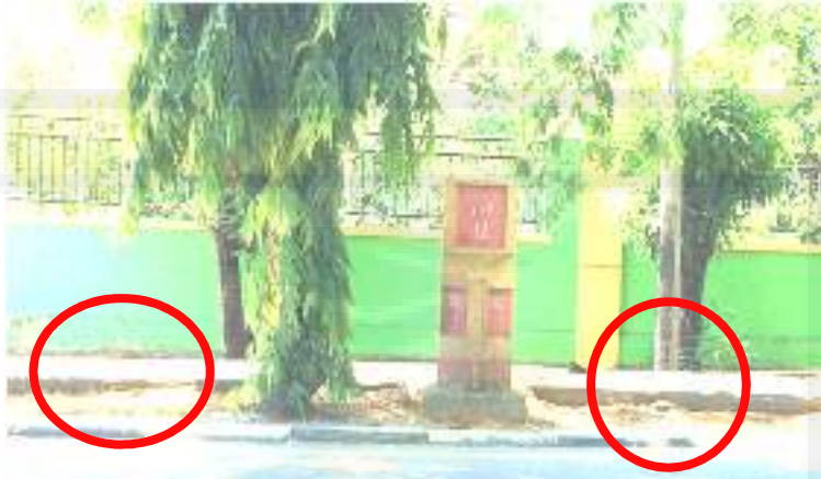
Gambar 3.4.4 Drainase tidak terdapat lubang penetes
