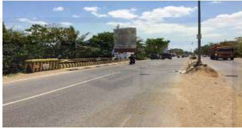
Dokumentasi Median pada Jembatan rusak
