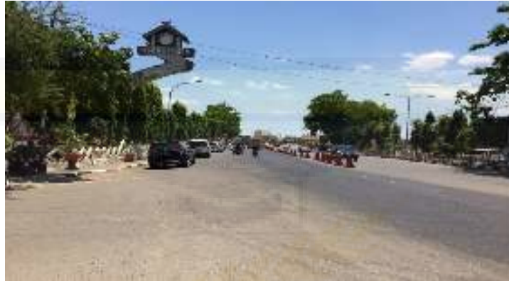
Dokumentasi jalan tidak terdapat marka
