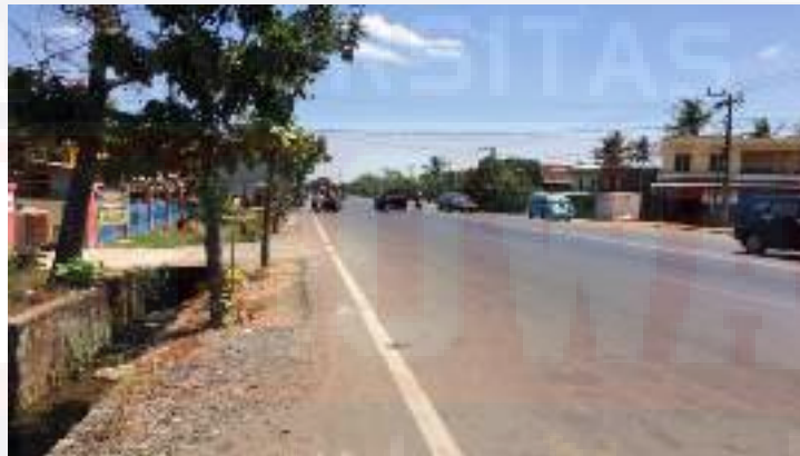
Dokumentasi jalan markanya sudah pudar
