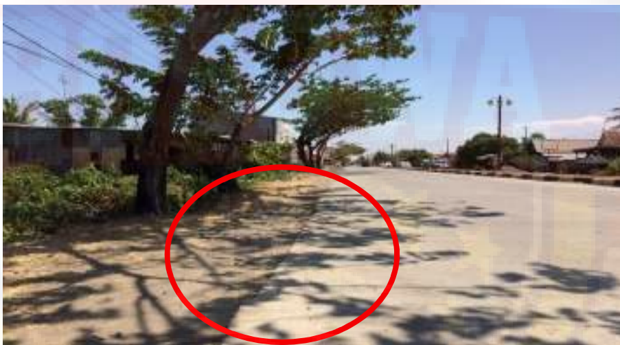
Gambar 3.4.3 Permukaan bahu jalan lebih rendah dari permukaan jalan (Tergerus)
