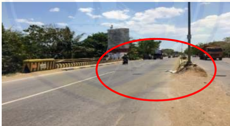
Gambar 3.4.1 Join rigid perkerasan retak dan median jembatan terbongkar
