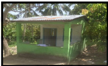
Gambar 4.9 Kondisi Pos Kamling
