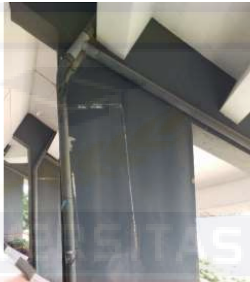
Gambar 3.9 : Saluran drainase pada kolom merusak estetika gedung
