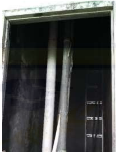
Gambar 3.10 : Sistem sanitasi yang dibiarkan terbuka dan tidak terawat
