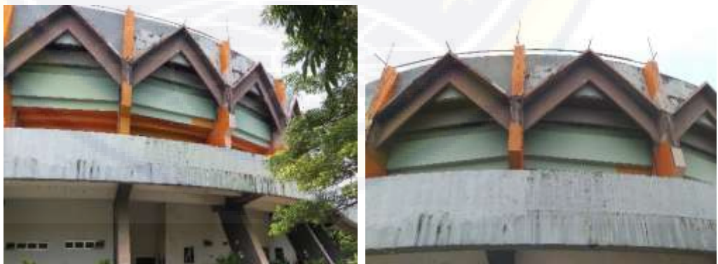
Gambar 3.11 : Tampak kerusakan pada fasade bangunan
