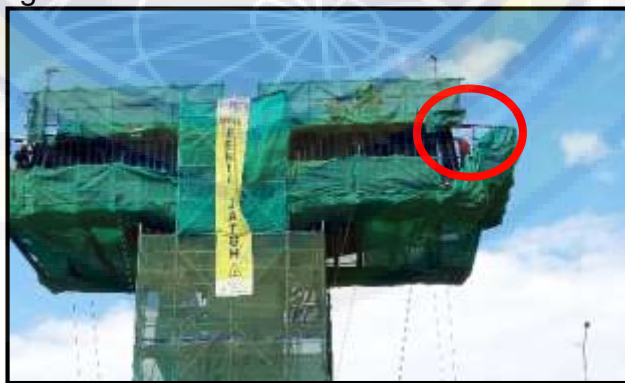
Gambar 4. 9 Salah satu pekerja tidak menggunakan body harness di ketinggian Sumber : Hasil Penelitian
