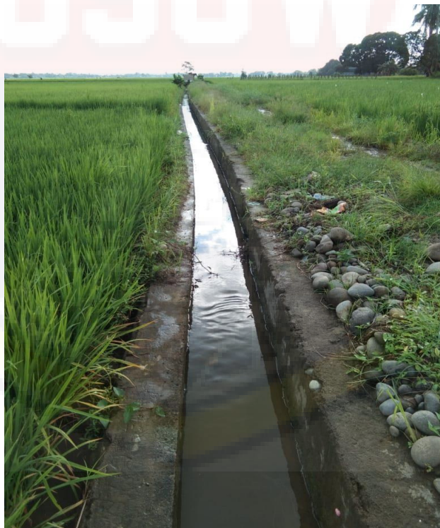
Gambar 4.3. kondisi dinding irigasi tersier Patarungan 3
