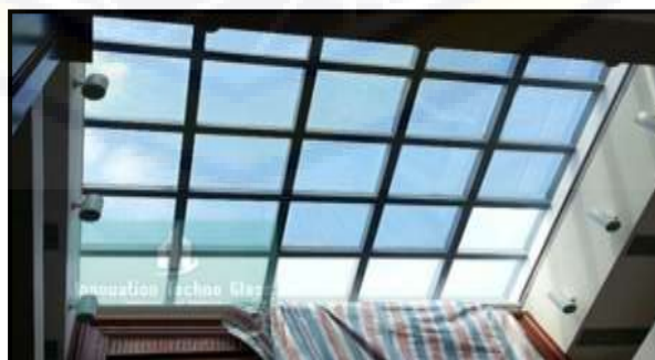
Gambar 6.18. Salah satu sistem pencahayaan alami pada bangunan Sumber : https://www.google.com/imgres.bp.blogspot.com
