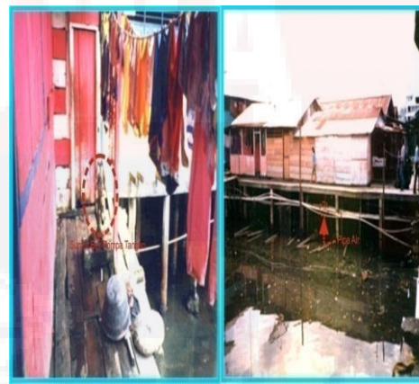
Kondisi Air Bersih Pipa air Bersih yang terletak Pada Tiang-tiang Rumah
