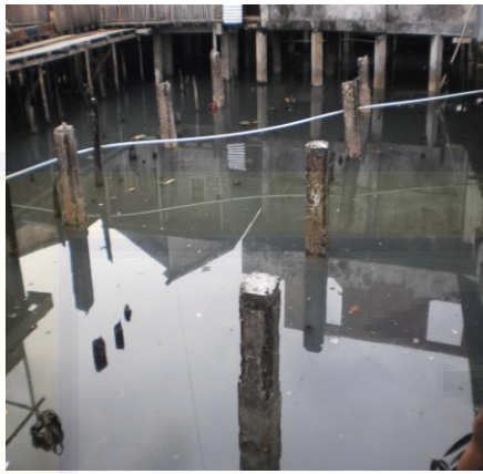
Kondisi Lingkungan Permukiman Yang kurang terawat
