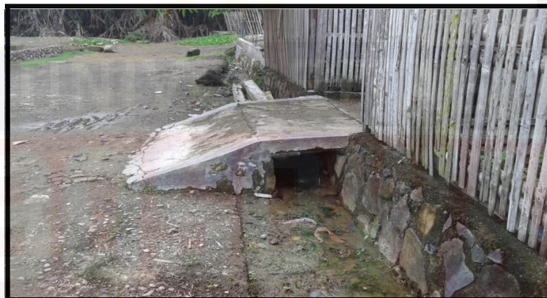
Gambar 4.3 Kondisi jalan yang tidak memiliki saluran di Kawasan Lappa
