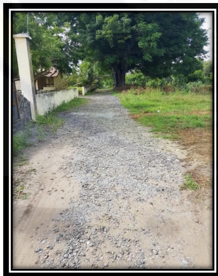
Gambar 4.2. Kondisi Jalan di Pasar Maritaing
