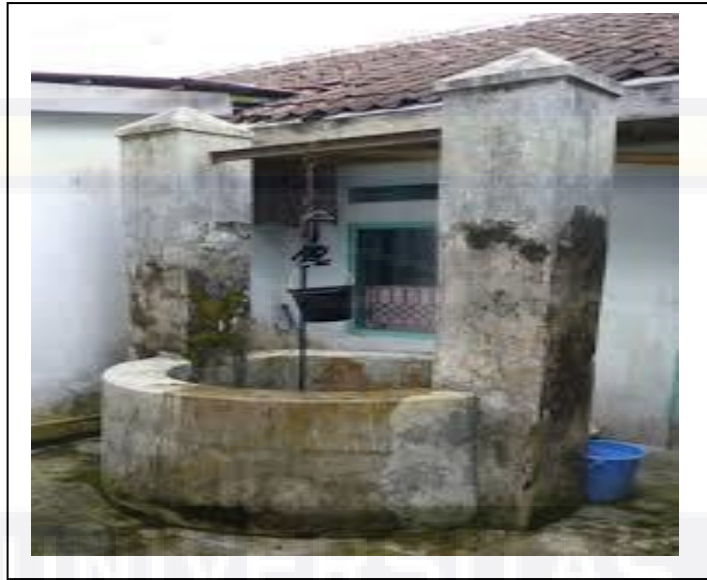
Air Bersih Yang tidak Terlindungi (Kelurahan Ampera)
