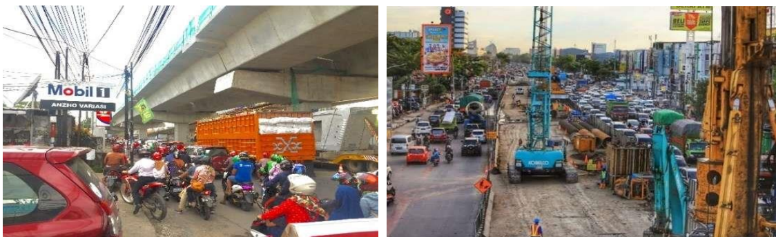
Gambar 5. Kondisi Kemacetan di Jalan A.P.Pettarani. Sumber : Survei Lapangan, 2020
