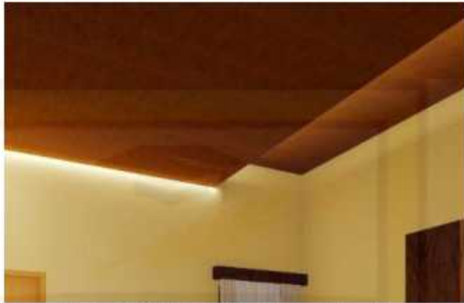
Gambar 3.15 : Plafon PVC pada ruang tidur cottage
