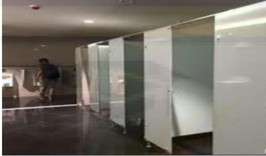
Gambar: 2. 16. Situasi Toilet Gedung Terminal Penumpang Pelabuhan Sukarno Hatta
