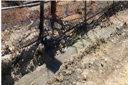
Jaringan Drainase Tahun 2020
