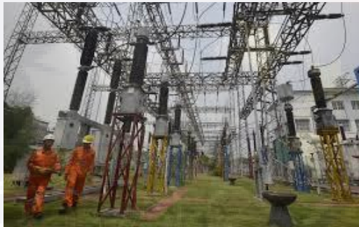
Gambar 2.1. Struktur baja pada switchyard gardu induk
