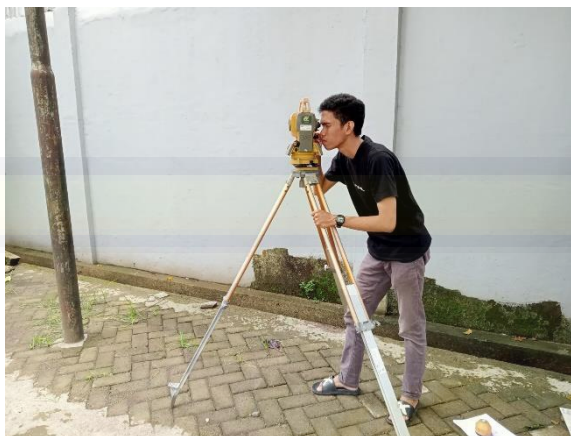
Foto : Penggunaan Alat Total Station Untuk Mengukur Elevasi Gedung Kampus I Universitas Bosowa
