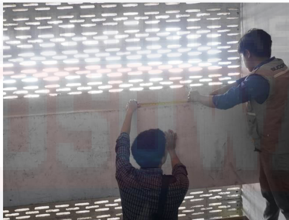
Foto : Pengukuran Jarak Tulangan Titik Balok Beton Gedung Kampus I Universitas Bosowa
