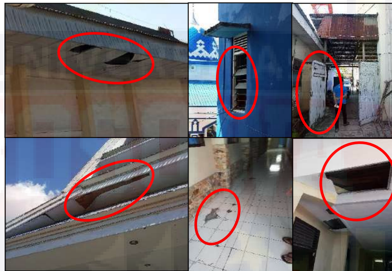
Gambar 1.5 : Beberapa titik kerusakan pada Kantor RRI Makassar
