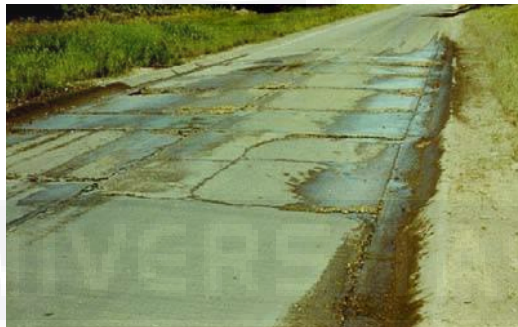
Gambar 2.14 Pumping pada perkerasan beton
