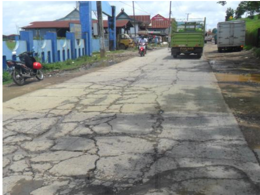
Gambar 2.20 Retak tidak beraturan pada perkerasan beton
