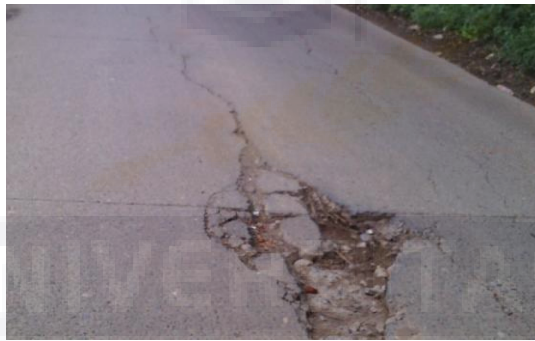
Gambar 2.26 Lubang (pothole) pada perkerasan beton
