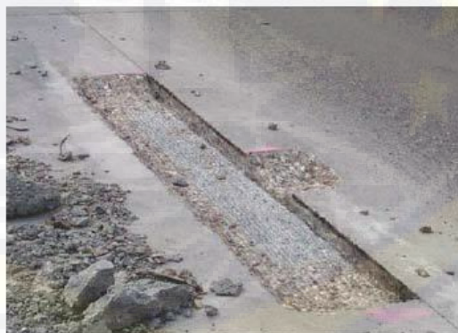
Gambar 2.24 Kerusakan bagian tepi slab (Sumber : Wahid Ahmad, 2009 )
