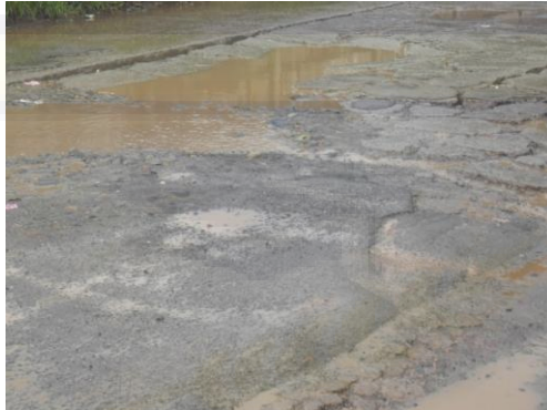
Gambar 2.12 Perkerasan beton yang mengalami amblas
