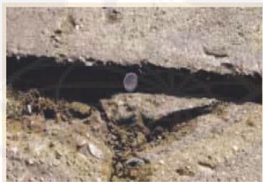
Gambar 2.13 Perkerasan beton yang mengalami patahan
