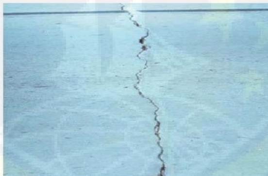
Gambar 2.21 Retak melintang pada perkerasan beton (Sumber : Wahid Ahmad, 2009 )
