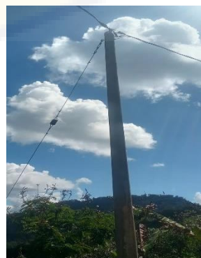
Gambar 4.23 Prasarana Jaringan Listrik
