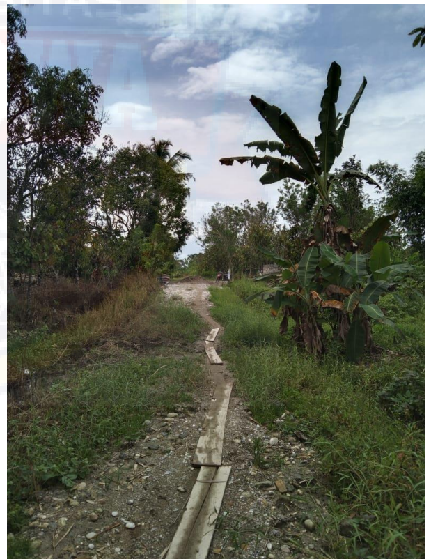
Kondisi jalan yang belum diperbaiki
