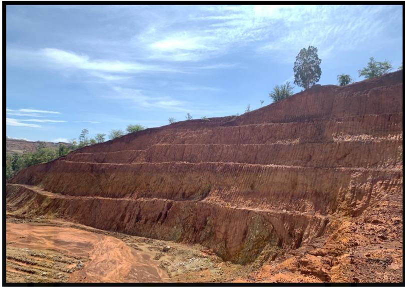
Gambar B. 1 Lereng front Mafhia bagian penampang Timur
