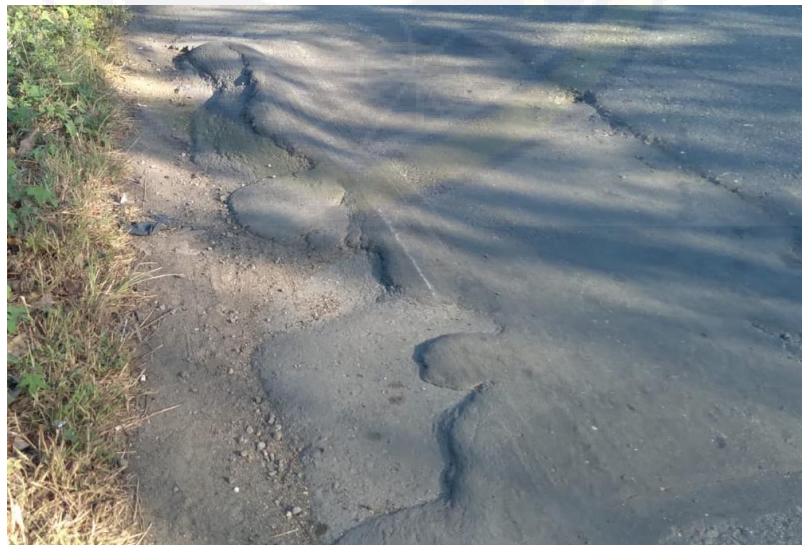
Gambar IV. 4 Kondisi jalan bergelombang (i) (lokasi Kabupaten Pangkep)
