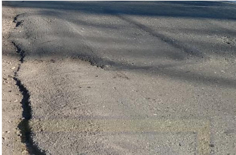
Gambar IV. 5 Kondisi jalan bergelombang (ii) (lokasi Kabupaten Barru)
