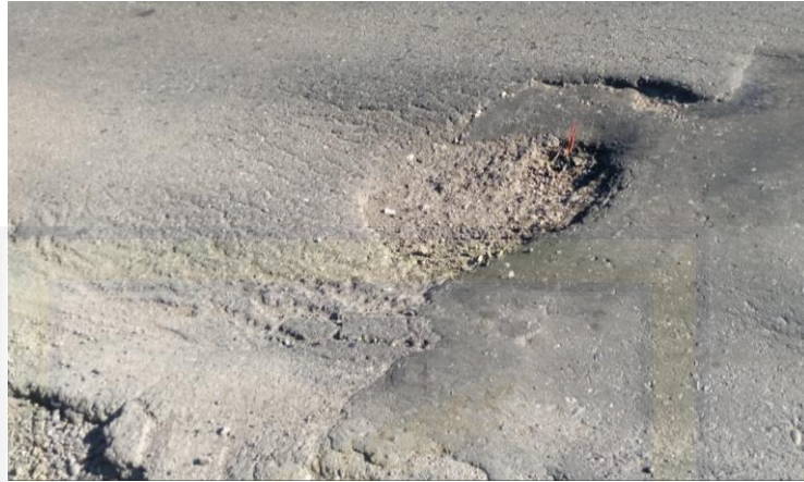
Gambar IV. 2 Kondisi jalan berlubang pada perkerasan lentur ( lokasi kabupaten Maros)
