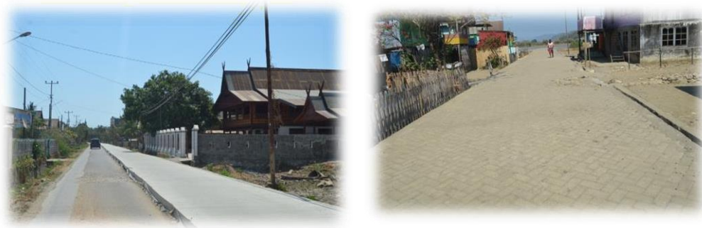
Gambar 4.8 : Kondisi Prasarana Jalan
