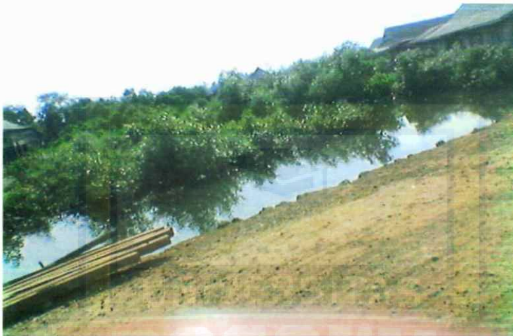
Gambar 4.12. kerusakan pantai akibat erosi/abrasi Dawi-dawi
