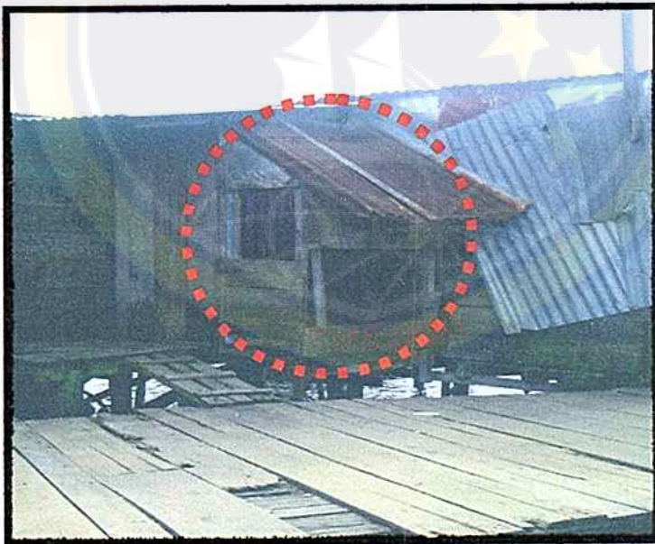
Gambar 4.14. Kondisi WC yang tidak layak, limbah langsung dibuang di saluran terbuka
