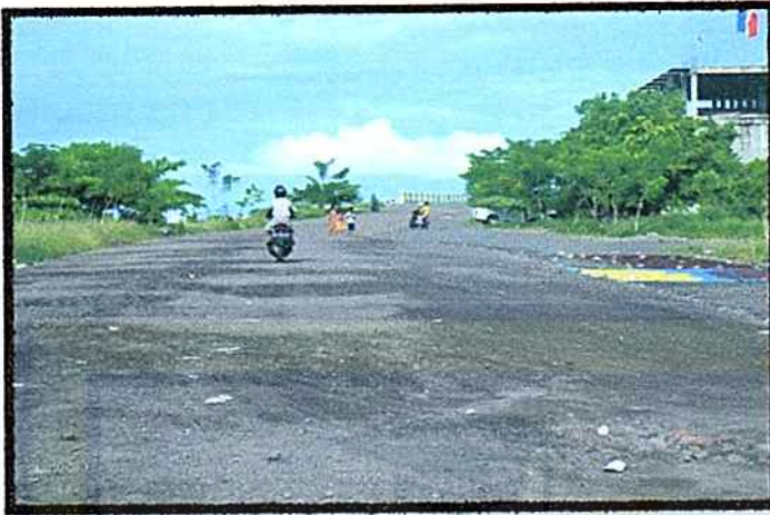
Gambar 4.6. Kondisi Salah Satu Jaringan Jalan Kolektor Sekunder
