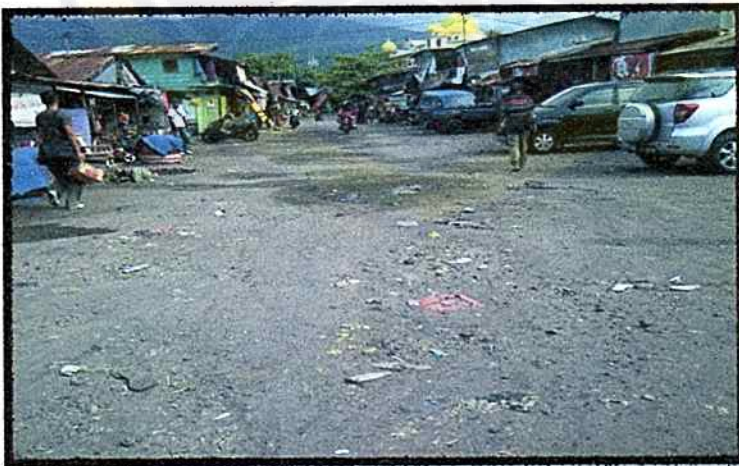
Gambar 4.9. Kondisi perkerasan jalan lingkungan yang rusak
