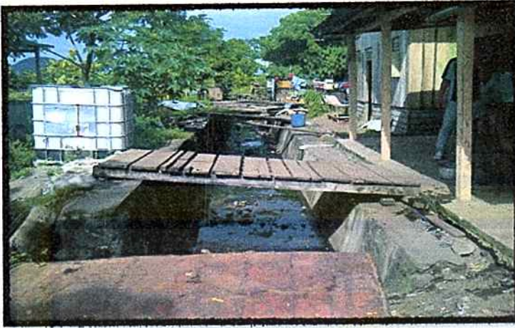
Gambar 4.22. Saluran yang tidak dapat berfungsi maksimal
