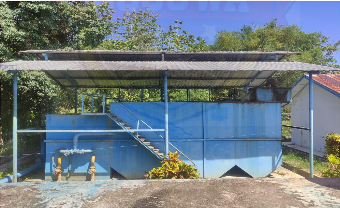
Dokumentasi 8. Instalasi Pengolahan Air
