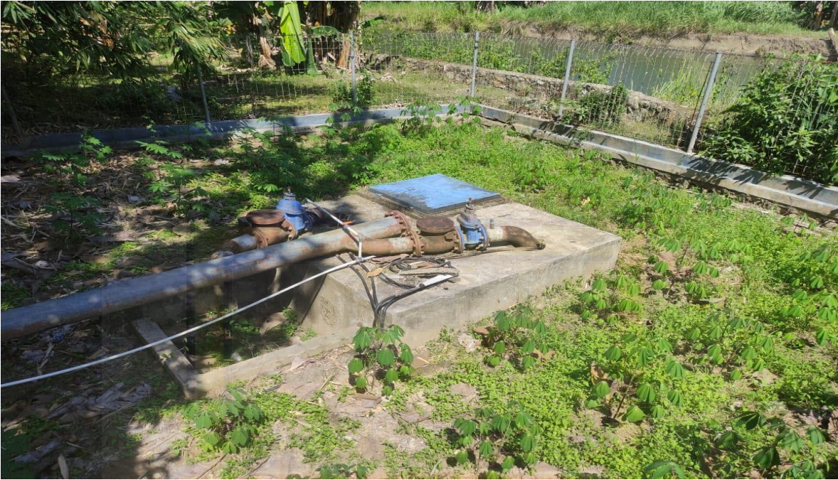
Dokumentasi 7. Pompa Air
