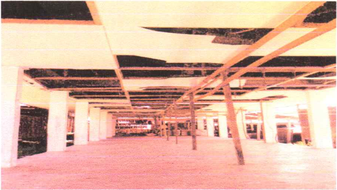
KONDISI PASAR TIDAK TERAWAT
