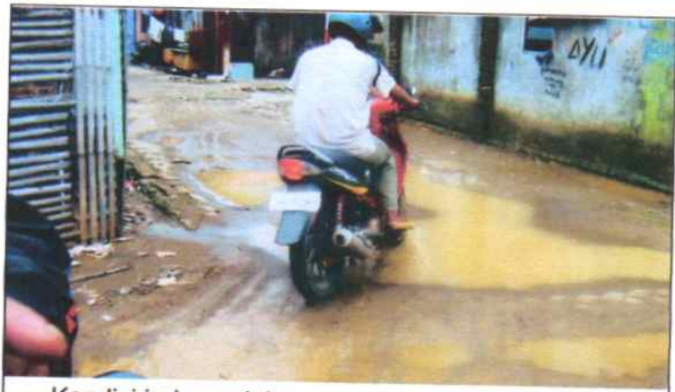
Kondisi jaringan jalan yang mengalami kerusakan dan memerlukan penanganan
