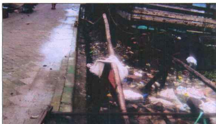
Lingkungan Permukiman belum memiliki jaringan drainase dan pembuangan sampah
