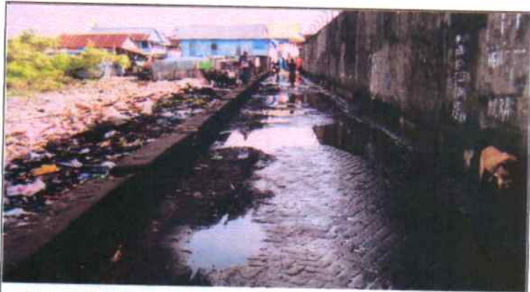
Kondisi jaringan jalan yang memerlukan penanganan dan prasarana pembuangan sampah
