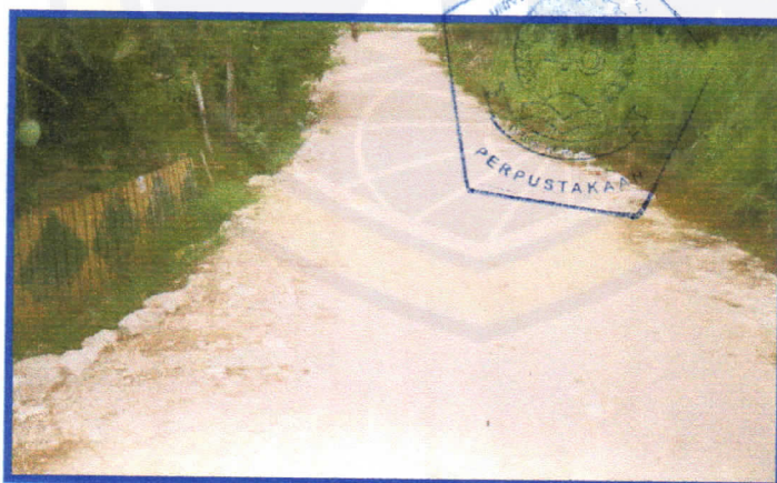
Gambar 6. Kondisi Jalan yang Ada di Desa Mundan dan Masih Pengerasan
