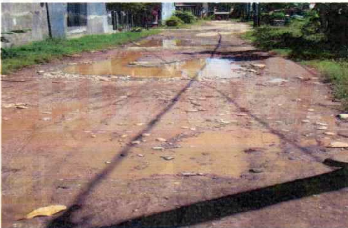
Gambar 03. Kondisi jaringan jalan di musim hujan
