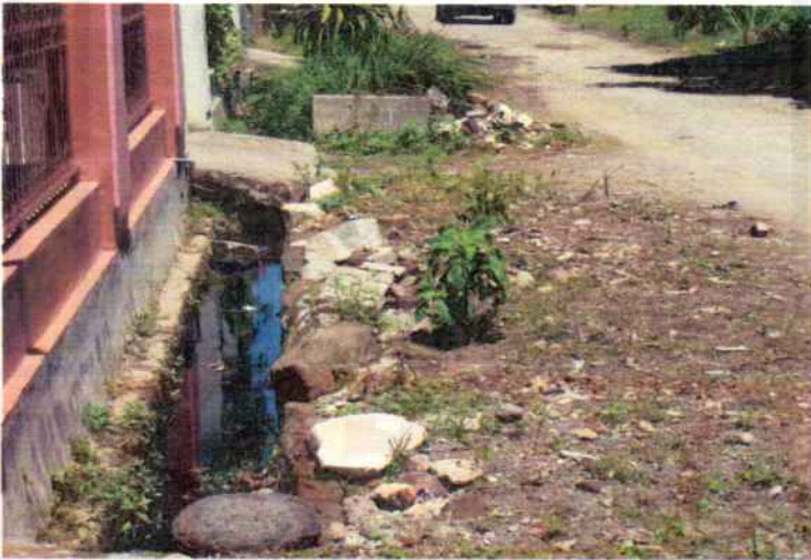
Gambar 05. Saluran drainase yang tidak mengalir
