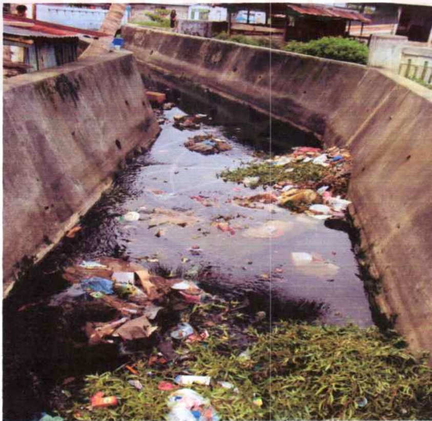
Tampak Drainase Primer yang di fungsikan untuk penbuangan sampah
