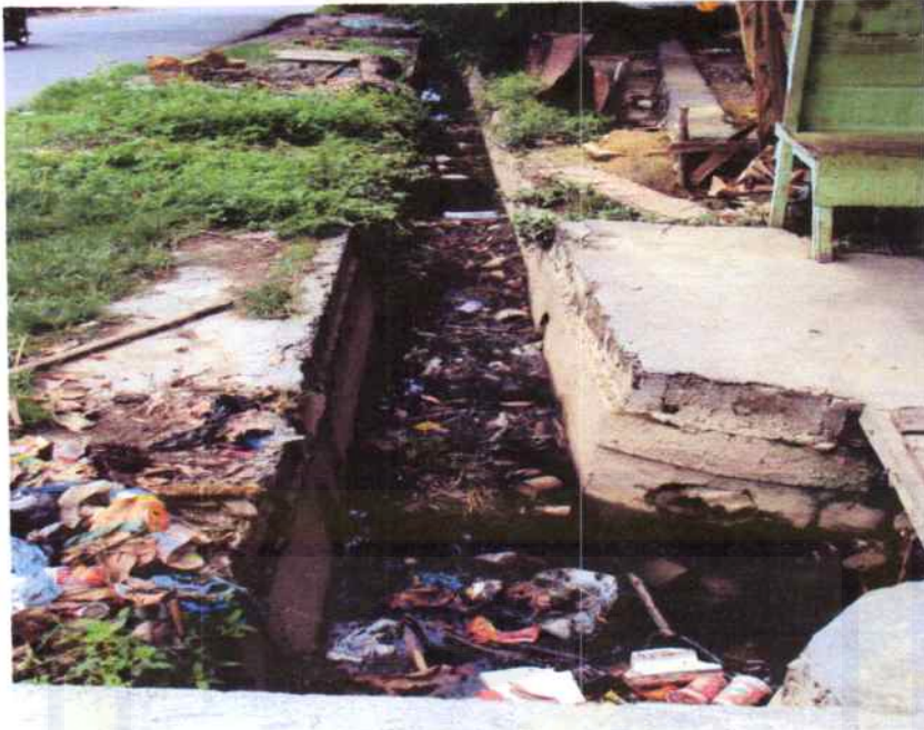
Tampak sampah yang di buang ke dalam drainase
