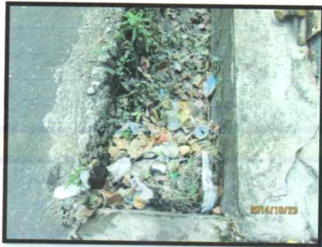
Gambar 4.9 Penumpukan sampah pada Drainase Tersier
