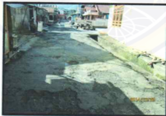
Gambar 4.7 Kondisi jalan lingkungan yang berlubang di Kelurahan Bastiong Karance
