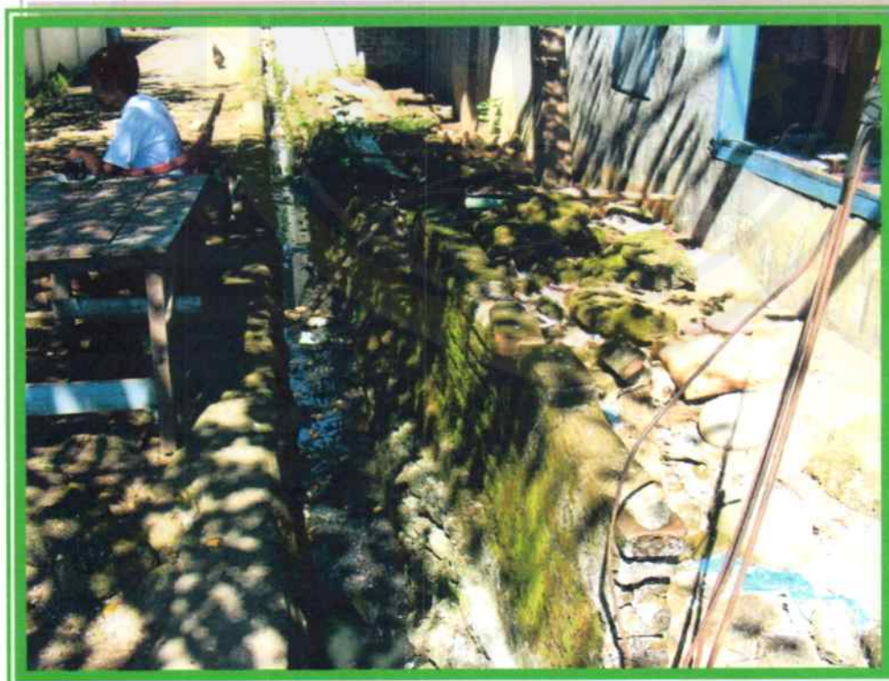
Kondisi drainase yang diameternya sangat kecil
