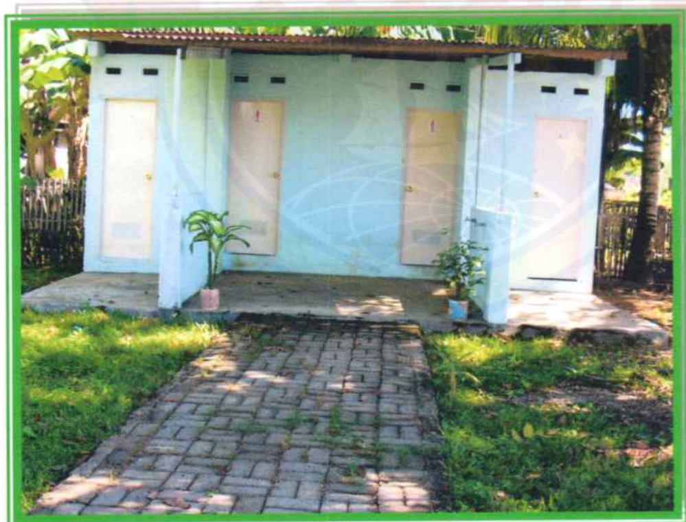
Kondisi sanitasi yang tidak difungsikan oleh masyarakat
