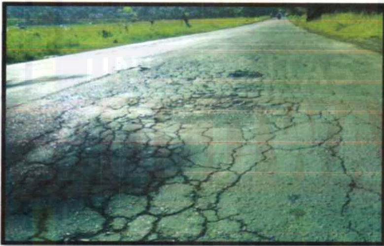
Gambar IV.4. Kerusakan permukaan jalan di sta 225 + 892 m tipe retak kulit buaya ( Alligator Cracks )
