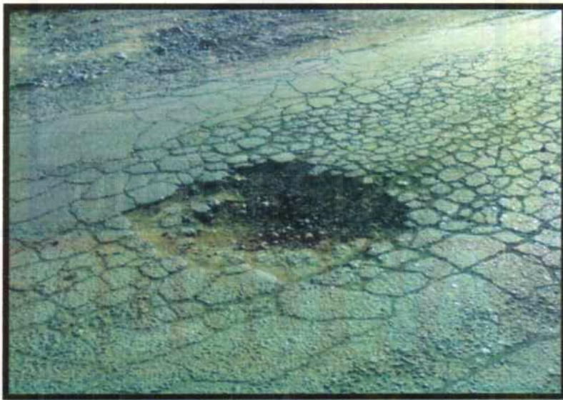
Gambar IV.2.; Kerusakan permukaan jalan di sta 224 + 742 m tipe lubang ( Potholes )
