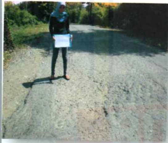
Kerusakan Pada Badan Jalan
