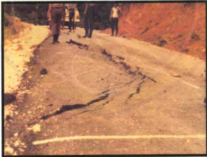
Gambar II.5 Jenis Kerusakan Jalan Ambles (Depression) Sumber : : DPU, 2005
