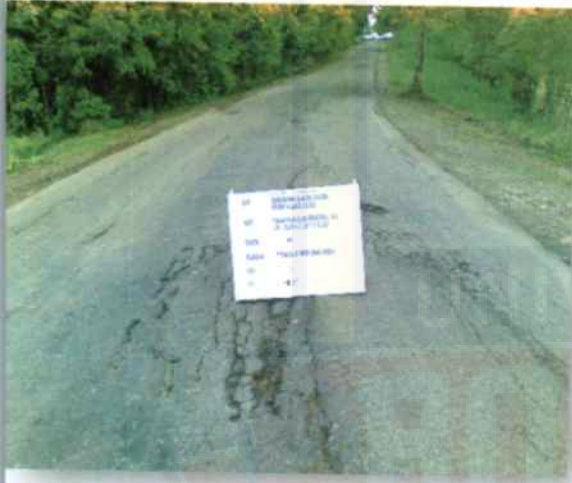
Kondisi Badan Jalan Yang Mengalami Penurunan
