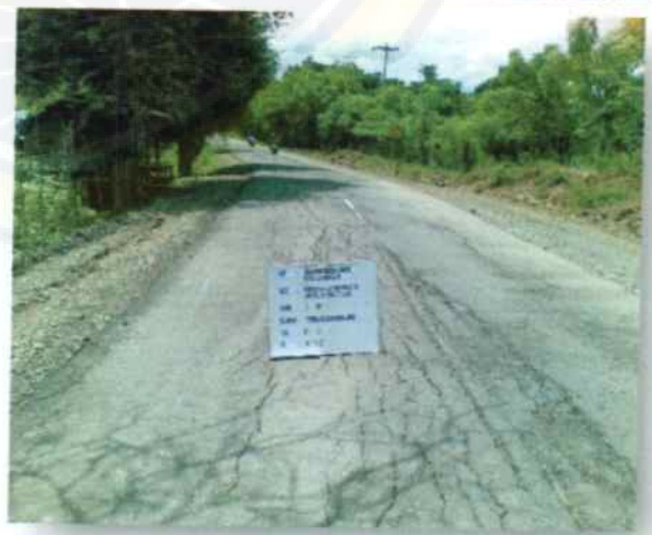
Kondisi Badan Jalan Yang Mengalami Penurunan
