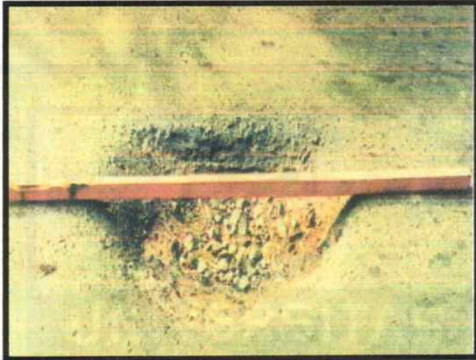
Gambar II.13 Jenis Kerusakan Berlubang (Potholes) Sumber : DPU, 2005
