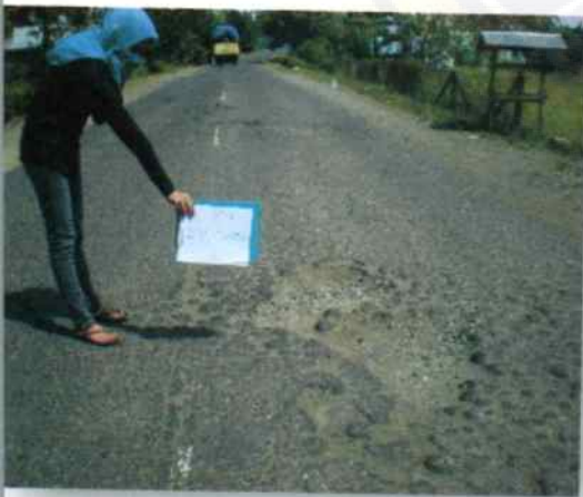
Kerusakan Pada Badan Jalan
