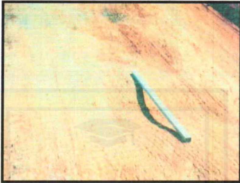
Gambar II.3 Jenis Kerusakan Jalan Bergelombang (Corrugation) Sumber : DPU,2005
