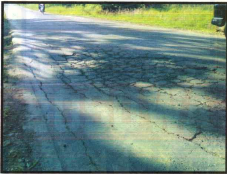
Gambar II.9 Jenis Kerusakan Retak Blok (Block Crack) Sumber : DPU,2005
