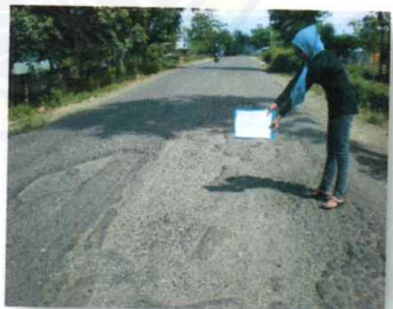
Kerusakan Pada Badan Jalan
