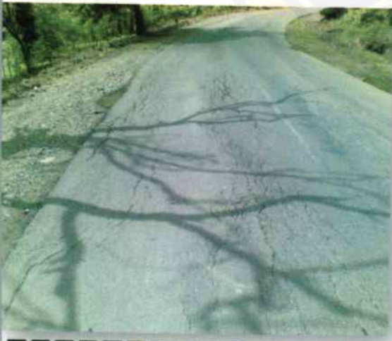
Kondisi Badan Jalan Yang Mengalami Penurunan
