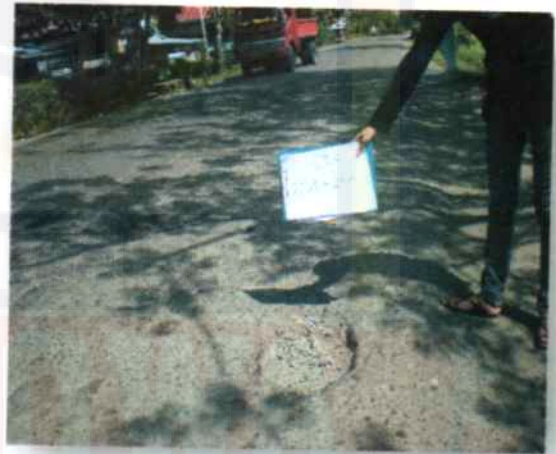
Kerusakan Pada Badan Jalan
