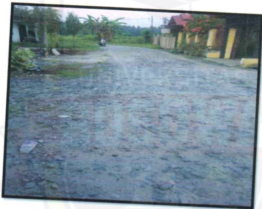
Gambar 4.9 kondisi jalan yang rusak di Perumahan Kelapa Gading Asri
