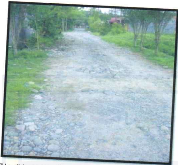
Gambar 4.7 kondisi prasarana jalan di Perumahan Kelapa Gading Asri
