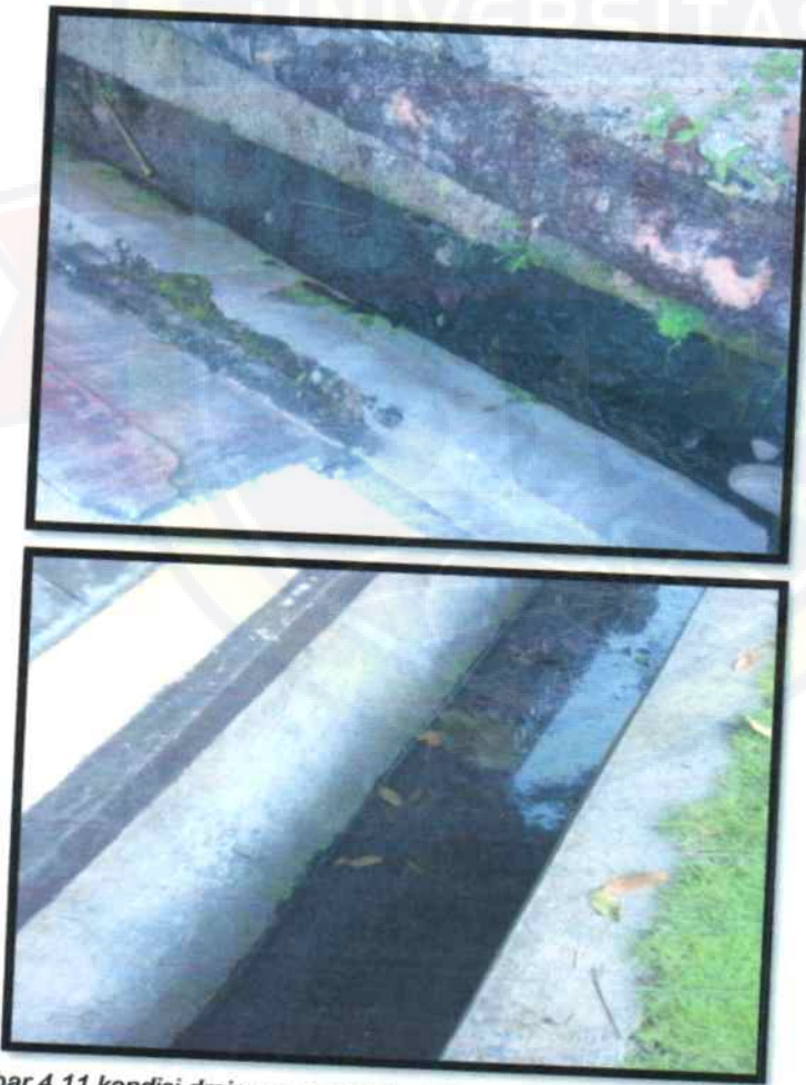
Gambar 4.11 kondisi drainase yang ada di Perumahan Kelapa Gading Asri
