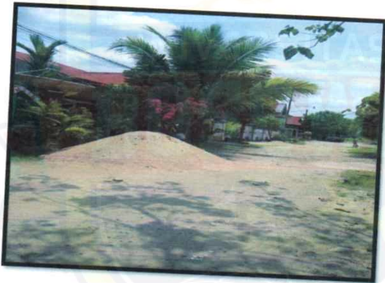
Gambar 4.8 kondisi lapisan permukaan prasarana jalan di perumahan Kelapa Gading Asri
